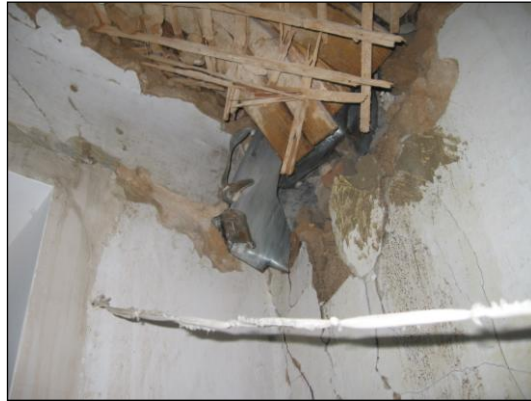
Хвостовая труба снаряда, пробившего перекрытия между вторым и первым этажами, застряла в потолке квартиры № 6.
